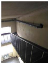
П.4.1.9. Отслоение и шелушение окрасочного покрытия стен и потолка.
