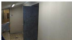
П.3.3. Дверной блок выхода на кровлю не соответствует нормам.
