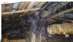
П.3.3.0,3 Поражение элементов стропильной системы огнем с потерей площади сечения до 80%.. Трещина усушки элементов стропильной системы.
