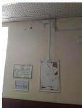
П.4.1.15. Отслоение и шелушение окрасочного покрытия стен и дверного блока. Замачивание и деформация потолочных панелей. Замачивание электрических кабелей.
