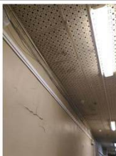
П.4.1.6. Отслоение и шелушение окрасочного покрытия стен. Замачивание и деформация потолочных панелей. Замачивание электрических кабелей.
