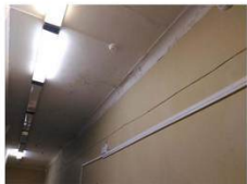
П.4.1.5. Отслоение и шелушение окрасочного покрытия стен и потолка.
