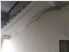
П.4.1.10. Отслоение и шелушение окрасочного покрытия стен и потолка.
