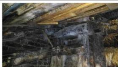
П.3.3.0,1 Поражение элементов стропильной системы огнем с потерей площади сечения до 80%.. Трещина усушки элементов стропильной системы. Огнезащитная обработка стропильной системы устарела.
