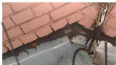
П.2.1.23. Дефект примыкания к парапету
