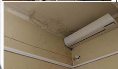
П.4.1.4. Отслоение и шелушение окрасочного покрытия стен и потолка. Следы замачивания стен и потолка.
