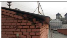
П.2.1.7. Разрушение кирпичной кладки
