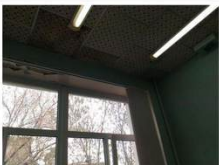
П.4.1.11. Отслоение и шелушение окрасочного покрытия оконных откосов.
