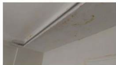
П.4.1.2. Отслоение и шелушение окрасочного покрытия стен и потолка. Следы замачивания потолка.
