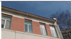
П.2.3.37. Шелушение и отслоение окрасочного покрытия наружных стен.
