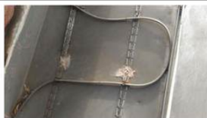
П.2.1.18. Крепление системы обогрева кровли по периметру выполнена не кровельным крепежом.
