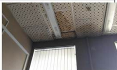
П.4.1.16. Отслоение и шелушение окрасочного покрытия стен. Замачивание и деформация потолочных панелей. Замачивание электрических светильников.
