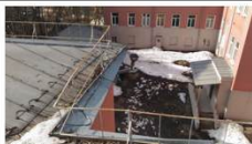
П.2.1.20. Деформация и разрушение воронки. Растительный мусор.
