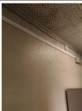
П.4.1.8. Отслоение и шелушение окрасочного покрытия стен. Замачивание и деформация потолочных панелей. Замачивание электрических кабелей.
