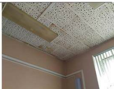
П.4.1.14. Отслоение и шелушение окрасочного покрытия стен. Замачивание и деформация потолочных панелей. Следы замачивания светильников.
