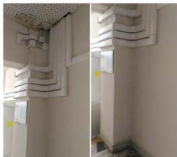
П.4.1.1. Отслоение и шелушение окрасочного покрытия стен. Замачивание и деформация потолочных панелей.
