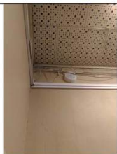
П.4.1.7. Отслоение и шелушение окрасочного покрытия стен. Замачивание и деформация потолочных панелей. Замачивание электрических кабелей.
